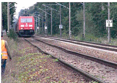
Bild 2 Deutliche zu erkennende Gleislagefehler im Abschnitt 5.
