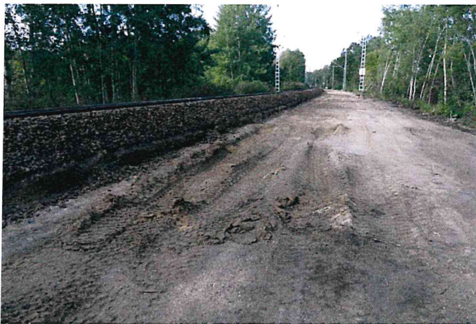
Bild 7 Blick auf das Planum vor dem Aufstreuen des Bindemittels. Das anhand der Fahrspuren zu erkennende abschnittsweise starke Einsinken der Baufahrzeuge zeigt die unterschiedlichen Auflageverhältnisse der Gleise. Dies war Grund für die Gleislagefehler.
